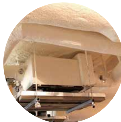
Canale pentru tubulaturi HVAC
